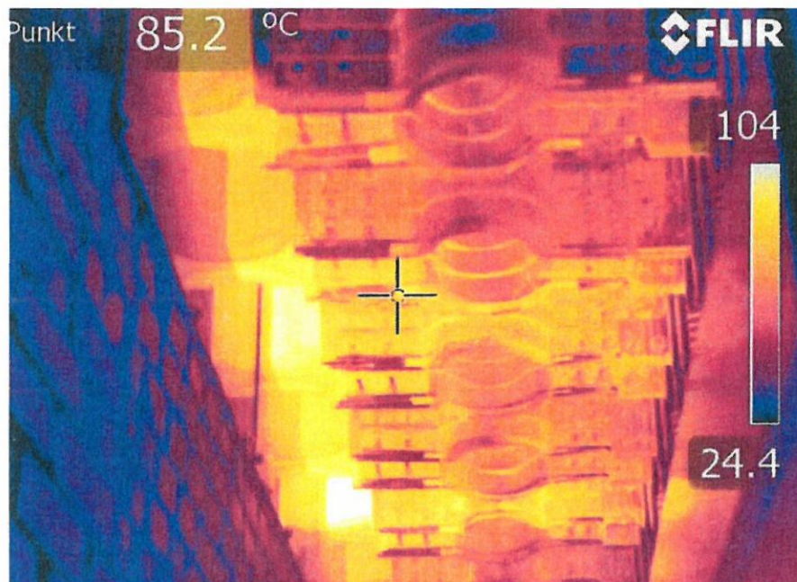
Rys. 1.41. Obraz złącza wykonany kamerą termowizyjną [obraz wykonany i udostępniony przez Holduct Sp. z o. o.]
